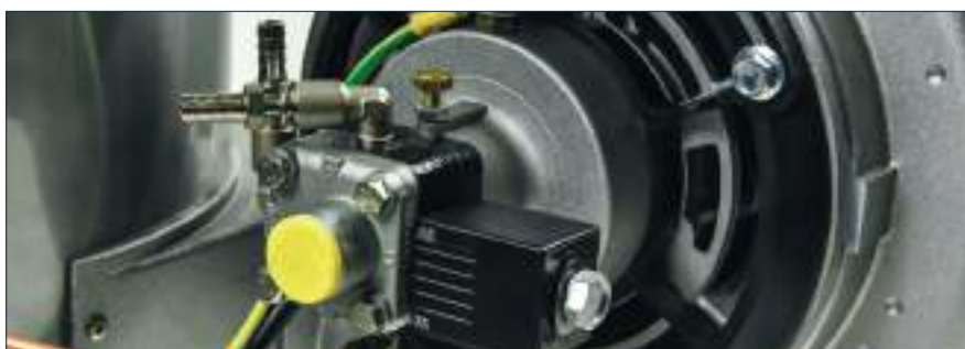
马达风扇 Fan and motor
